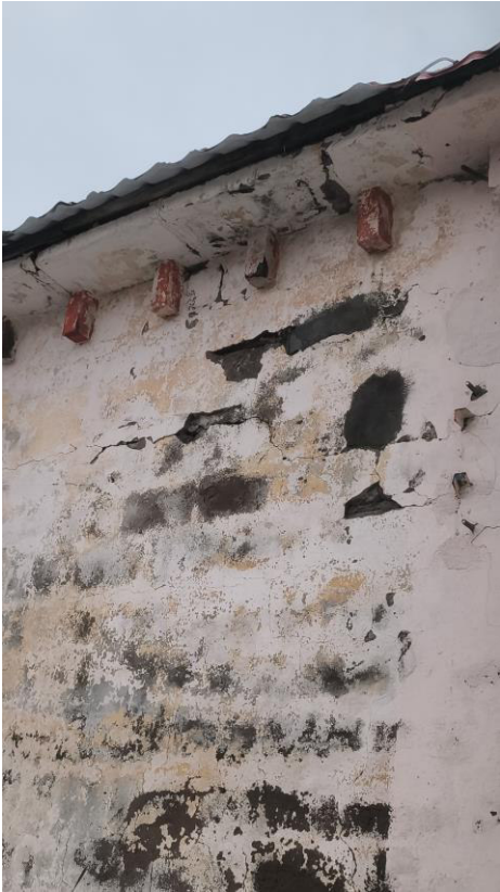
Фото 15. Деструкция бетона блоков несущих стен, карнизные плиты подперты кирпичами с одной стороны и на металлических скрутках с другой.\
