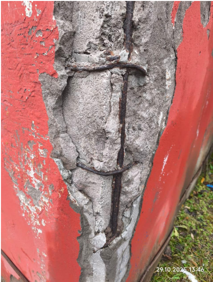
Фото 4. Деструкция бетона (включений-колонн), коррозия рабочей арматуры, определение остаточного диаметра на данном участке
