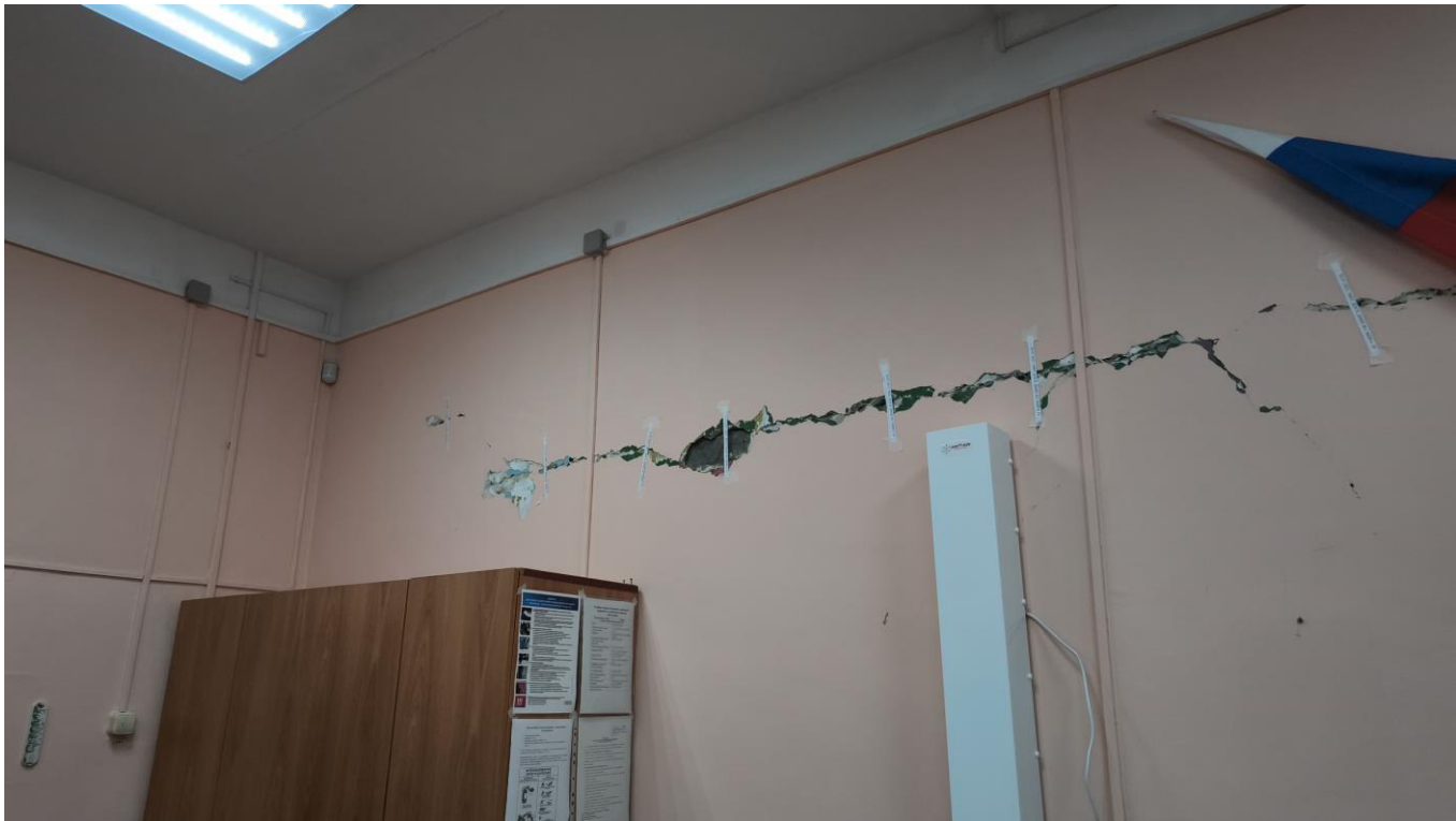
Фото 14. Силовые сквозные трещины – повсеместно
