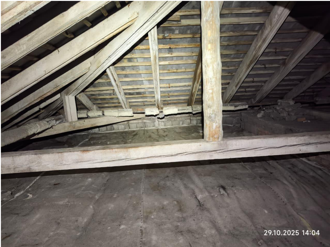
Фото 10. Мауэрлат не закреплен (повсеместно, крепление карнизных плит к стропильным ногам металлическими скрутками)
