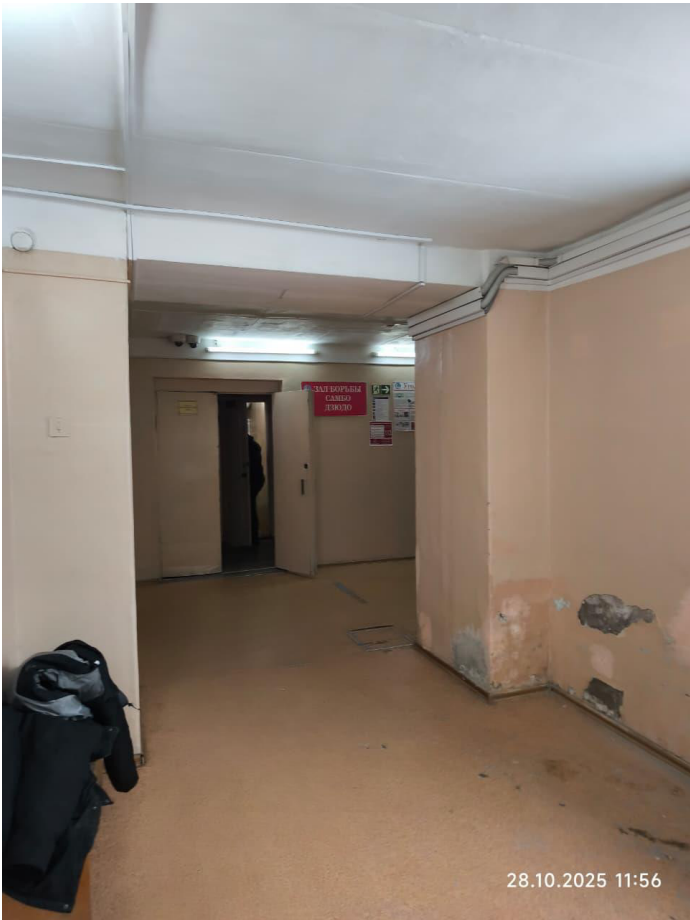
Фото 9. Стык блоков, деформационный шов. Деструкция бетона в результате замачивания.
