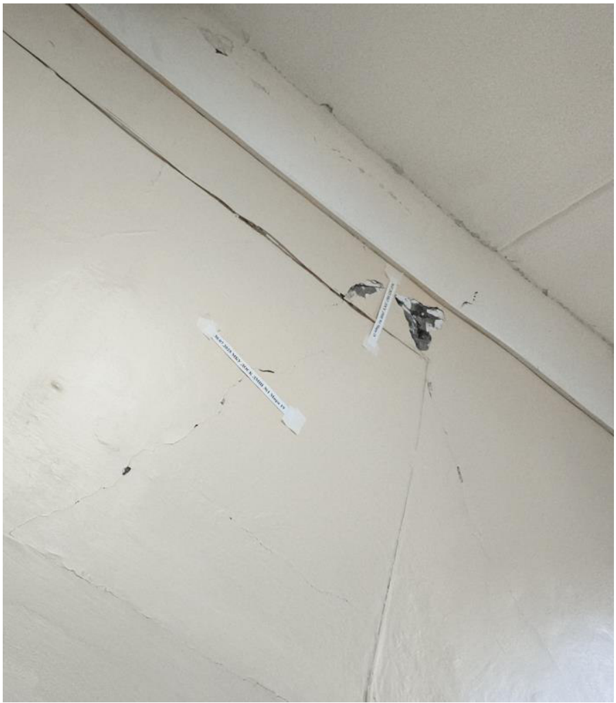
Фото 13. Силовые сквозные трещины – повсеместно
