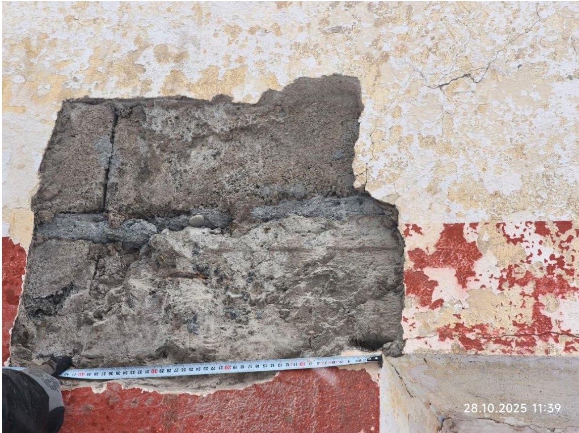
Фото 8. Перемычка над окном. Деструкция бетона, коррозия рабочей арматуры перемычки.
