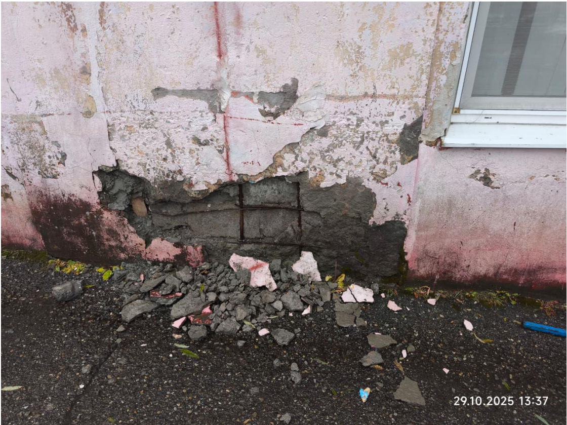
Фото 3. Деструкция бетона (включений-колонн), коррозия рабочей арматуры, определение остаточного диаметра на данном участке
