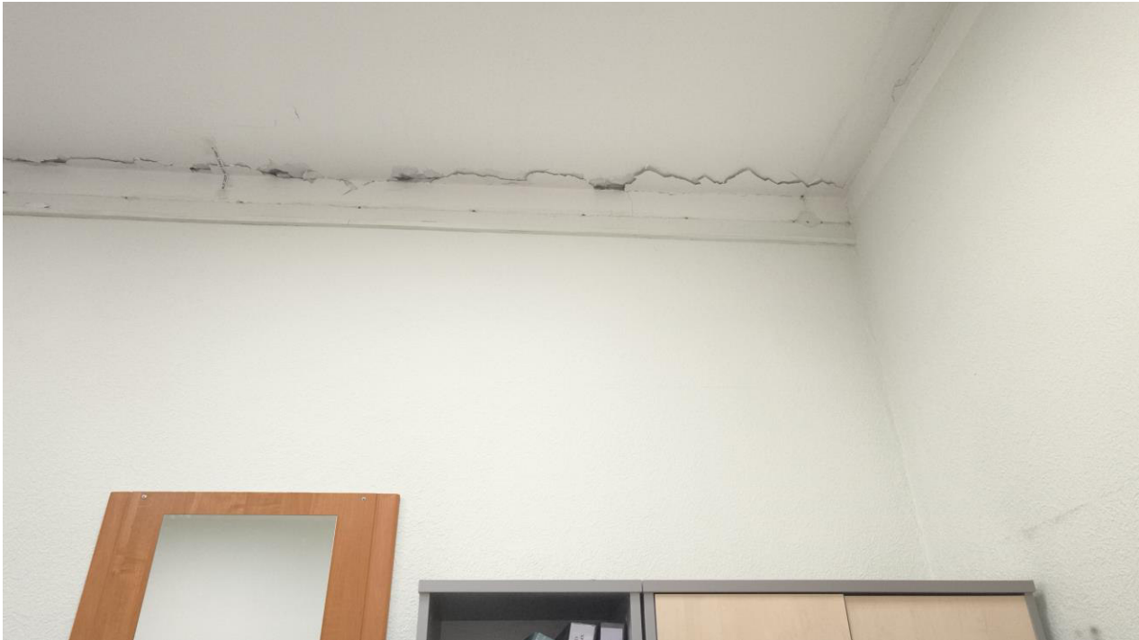
Фото 12. Трещины по контура перекрытия и несущих стен
