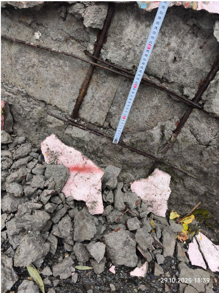
Фото 6. Деструкция бетона (включений-колонн), коррозия рабочей арматуры, определение остаточного диаметра на данном участке
