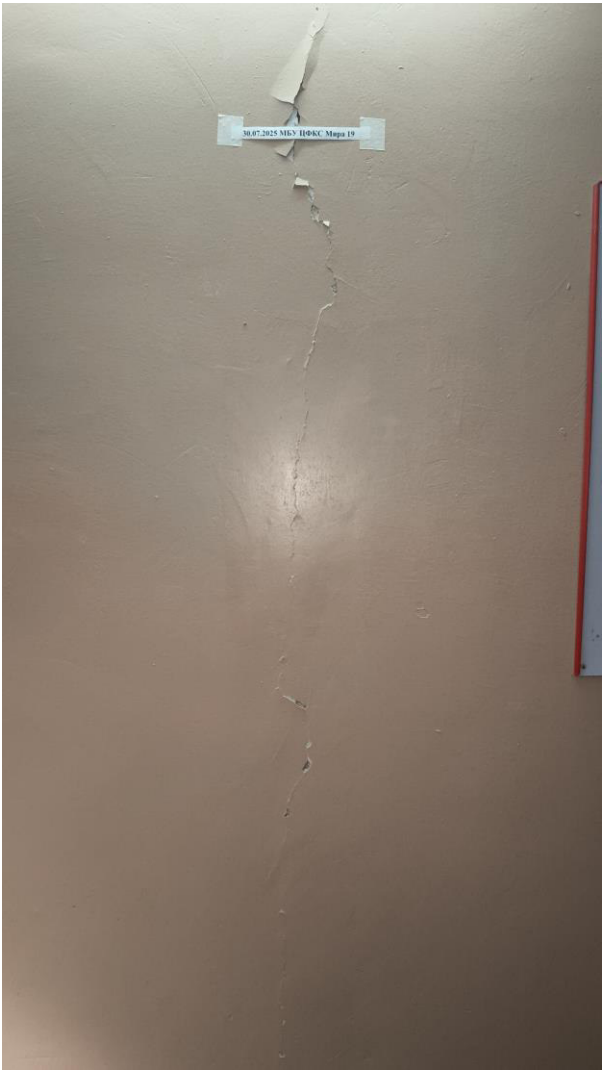
Фото 11. Силовые сквозные трещины – повсеместно
